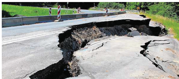
Ein Hangrutsch in einer der Hambachkurven zwischen Kaltenbrunn und Ebern erfordert die große Baumaßnahme.
